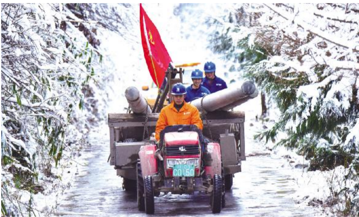
1月3日,受冷空气影响,广元市陆续降雪,其中旺苍片区10千伏大万路912线路大旭支路杆塔、导线覆冰严重,造成倒杆断线灾情,使得五权镇旭光乡52户居民停电。由于道路结冰,电杆运输困难,为早日送上电,该村村民义务出力,出动拖拉机运送电杆,帮助国网广元供电公司抢险队恢复送电。图为1月7日,电力工人开拖拉机运送电杆上山。(杨笃君 摄影报道)
