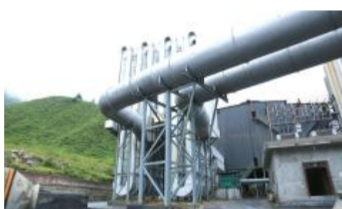
海棠工业园区银都新材料公司环保设施
