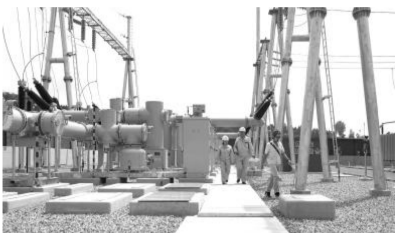
南部河东科技工业园区110千伏天鼓岭变电站
